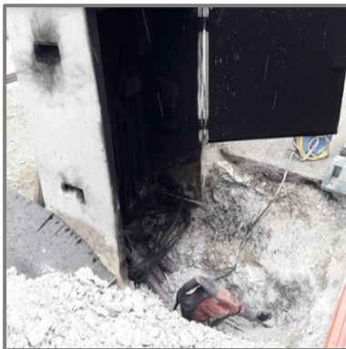
Cabina di distribuzione TV distrutta dal fuoco a causa di un cortocircuito
