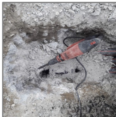
Martello a punta utilizzato con cui inavvertitamente è stato danneggiato un cavo.
