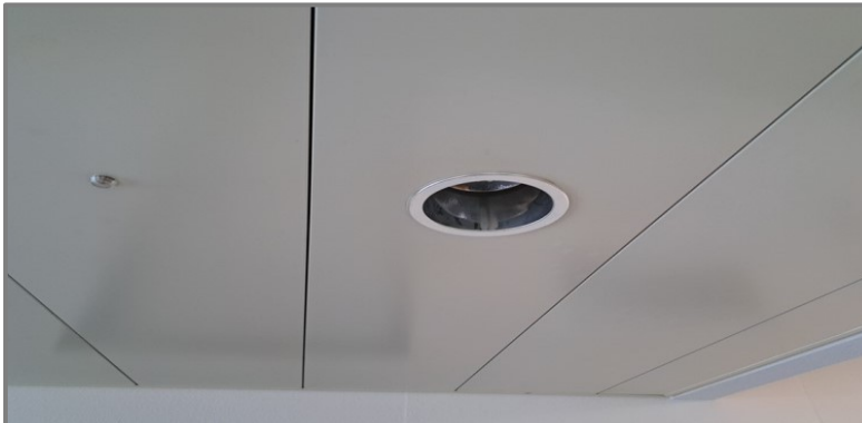
Oggetto dell'infortunio: durante il montaggio dei faretti da incasso si è staccato un cavo che si trovava sotto tensione.
