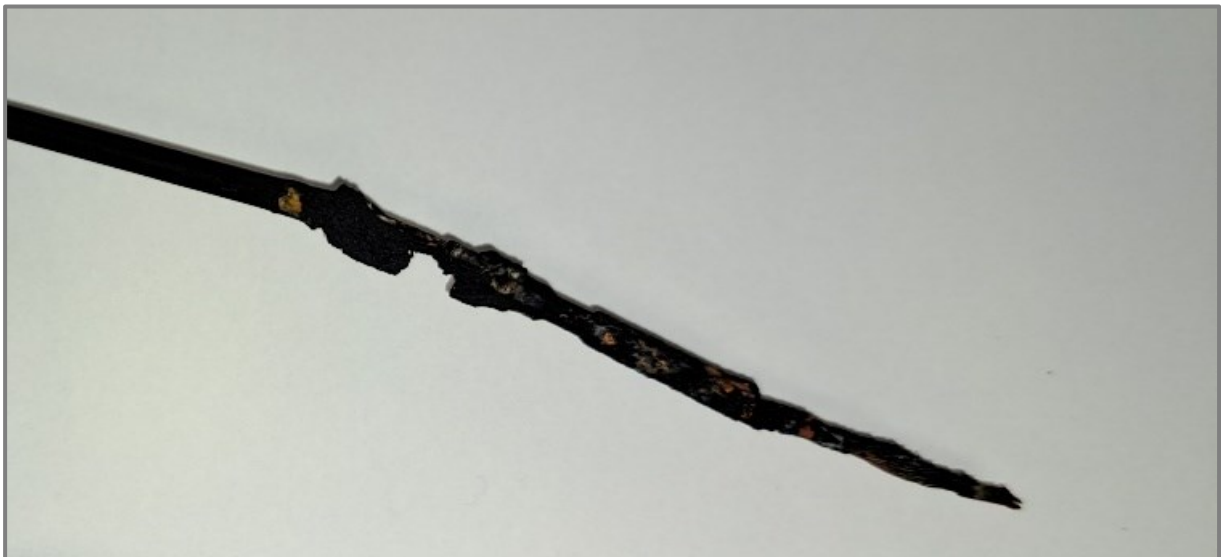
DC-Leitung (Stringkabel) nach Kurzschluss
