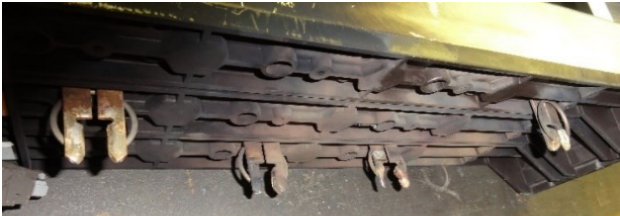
Grundkonstruktion Klemmkontakte nach Kurzschluss
