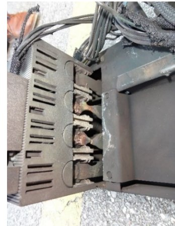
Traces de court-circuit
