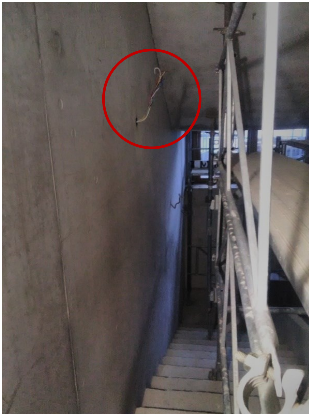
Cage d'escalier (lieu de l'accident)
