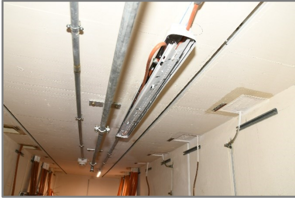
Unfallverursachende LED-Leuchte ohne Kunststoffabdeckung
