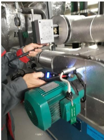
Prüfen des Schutzleiters bei einer HLKS Anlage
