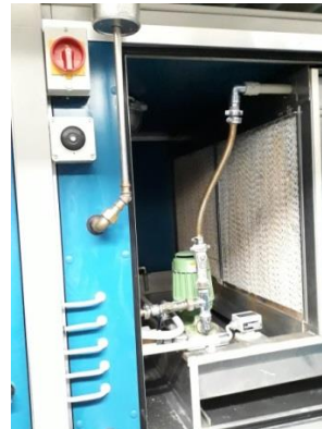
HLK Anlage hinter Anlageschalter
