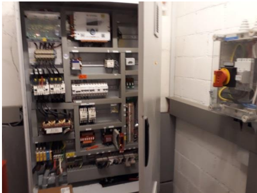
Impianti per ascensori a valle del loro interruttore principale
