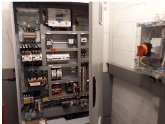
Commande d'ascenseur en aval d'un interrupteur principal
