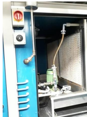
Installation de climatisation/ventilation en aval d'un interrupteur principal
