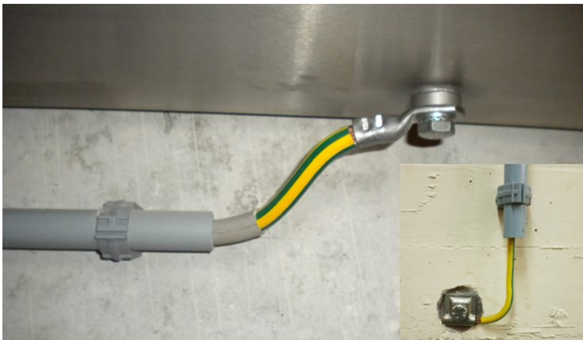
Figur 13 Anschlussstelle ZS für den Schutzpotenzialausgleich in max. 1.0 m Entfernung
