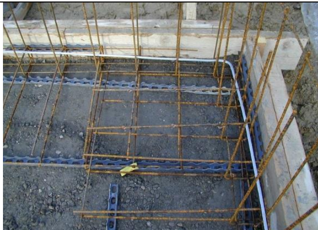
Bild 1: Erdungsanlagen sind vor der Eindeckung und der Fundamenterder vor dem Einbetonieren durch eine Fachperson auf ihre richtige Ausführung zu kontrollieren oder nach Absprache mit der Brandschutzbehörde oder dem Kontrollorgan mit Bildmaterial zu dokumentieren. Siehe: SNG 483755 + SNR 464113
