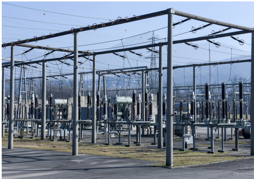
Abbildung 1 Von allen im Jahr 2020 durch das ESTI behandelten Plangenehmigungsverfahren bezogen sich 5514 auf Stationen (Unterwerke, Transformatorenstationen) und Leitungen.
