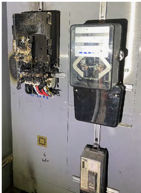
Abbildung 4 Elektrounfall an Energiezähler in bestehender Schaltgerätekombination
