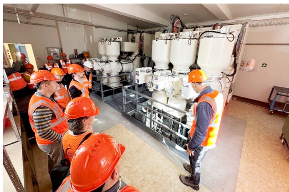
Figura 5 Impianto di comando presso la sottostazione di Sainte-Croix
