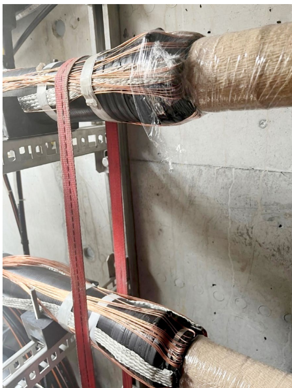
Figura 3 Punto di connessione predisposto per il manicotto del cavo della linea tra le sottostazioni di Schwanden e Löntsch
