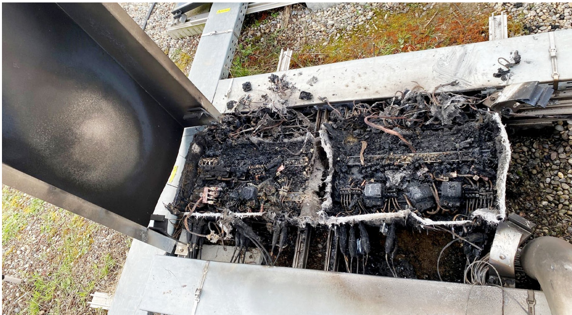
Figura 8 Cortocircuito sulla scatola di raccordo del generatore di un impianto fotovoltaico
