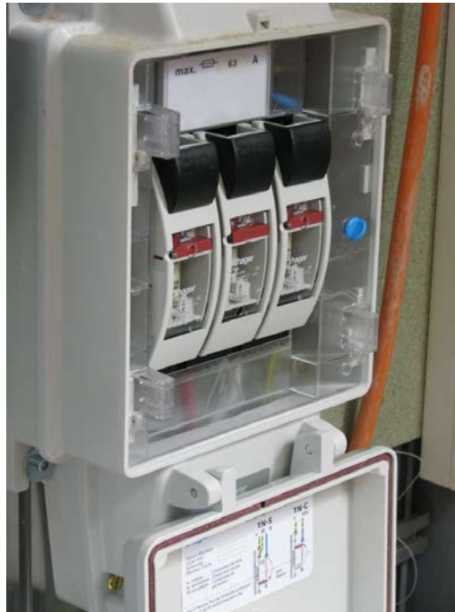
HAK mit Berührungsschutz: Prüfbar ohne Abstellen. (Bild4)
