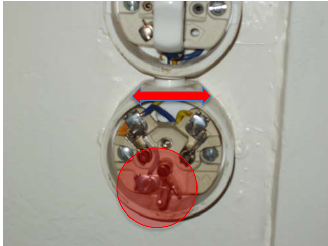
Bild 1: Steckvorrichtung T 14 Aussenleiter (Polleiter) – Neutralleiter verwechselt in Nullung Schema III, durch die Brücke N-PE ist der PE jetzt unter Spannung
