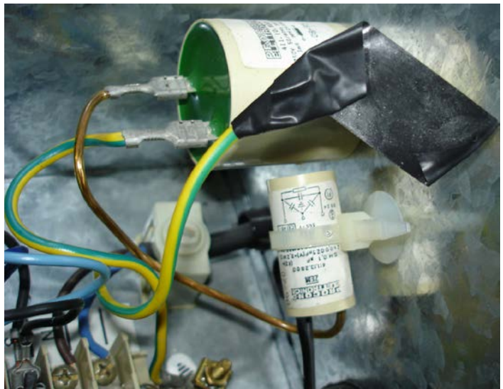
Conducteur de protection suspendu, que le monteur a détaché et isolé.
