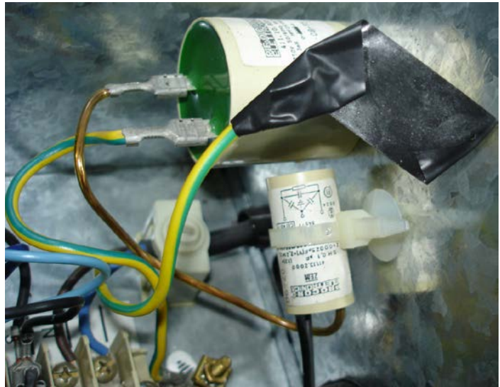
Conduttore di protezione distaccato, che il montatore del servizio di assistenza clienti ha staccato e isolato.
