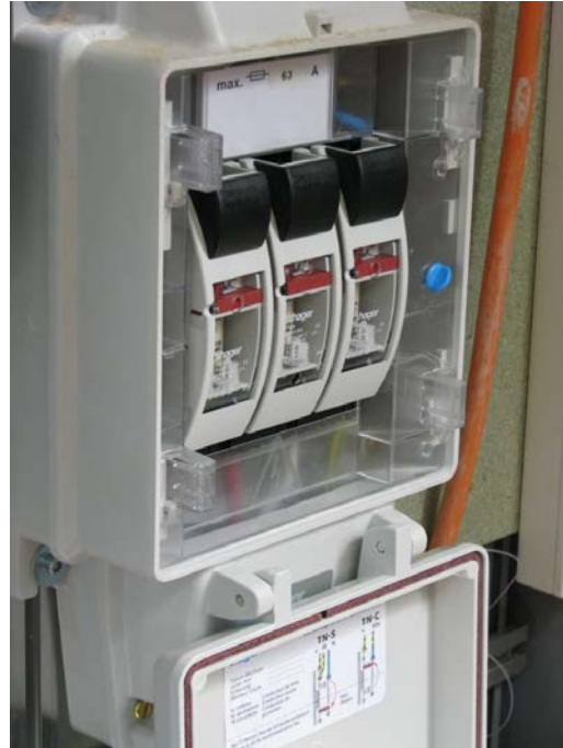
Cassetta di allacciamento dell'edificio con protezione anti contatto e possibilità di eseguire il controllo senza rimozione. (Figura 4)
