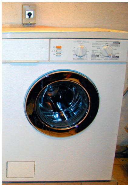
Foto 1 Keine Installationsbewilligung für Arbeiten innerhalb des Erzeugnisses (Monoblock).
