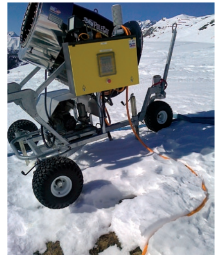
Bild 4 Zuleitung zu Schneekanone. Nicht normenkonform!
