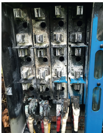
Bild 6 Durch Kurzschluss beschädigte Schaltgerätekombination ohne korrekte Schutzabschaltung.
