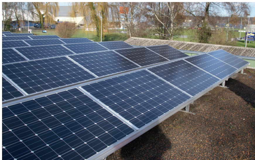
Figure 1 Panneaux solaires sous tension dès que le soleil brille.
