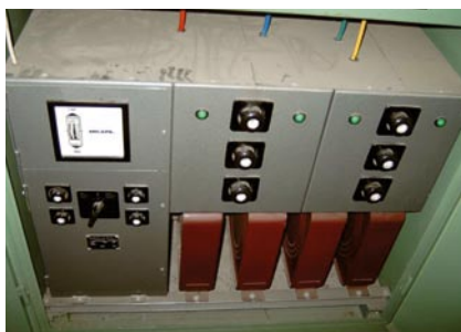
Un système de compensation d'énergie réactive avec la commande correspondante.
