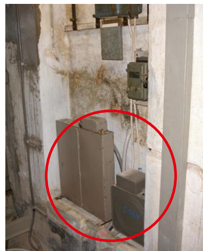
La foto mostra i condensatori della compensazione della corrente reattiva (cerchio).
