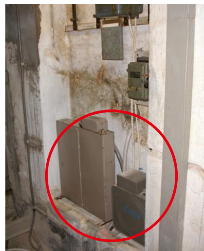
Das Bild zeigt die Kondensatoren zur Blindstrom-Kompensation (Kreis).
