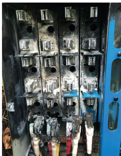
Figura 6 Apparecchiature assiemate di protezione e di manovra danneggiate da cortocircuito senza scatto del fusibile.
