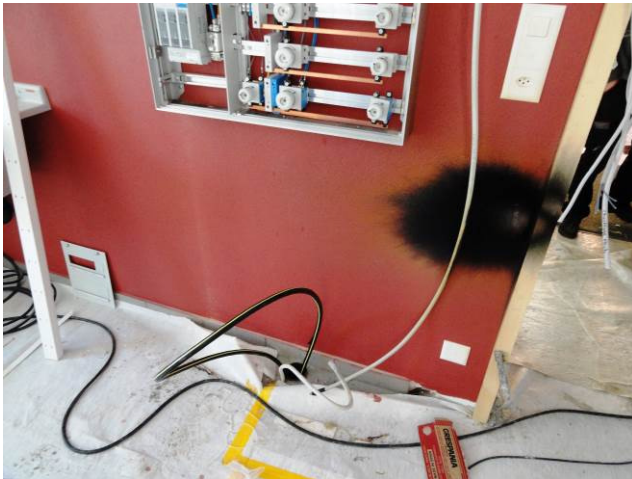
Links: Die Auswirkungen des Kurzschlusses sind gut sichtbar.
