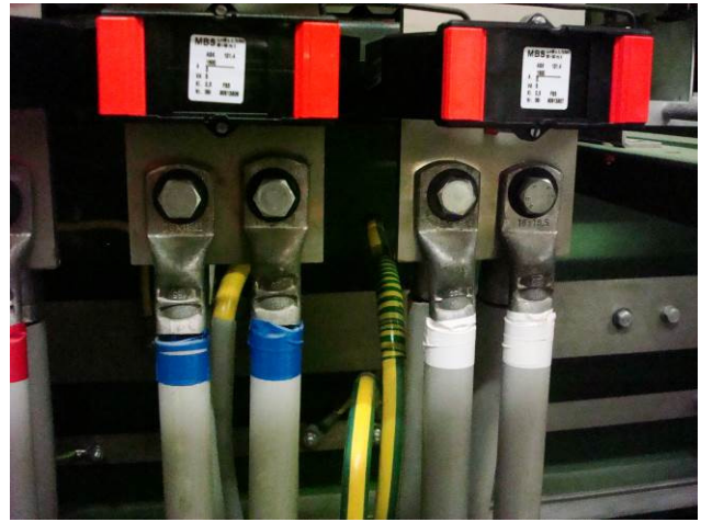
Anschluss ab Transformator mit dem zu messenden Erdleiter. Unfallstelle.
