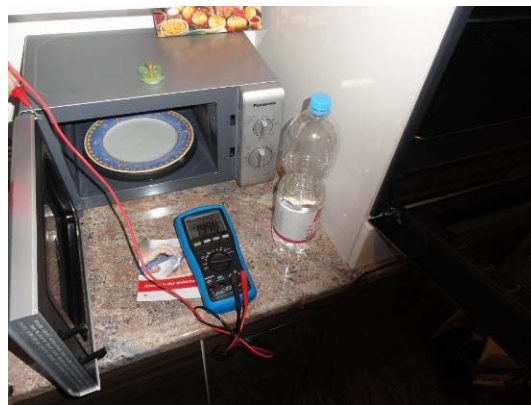
Spannungsdifferenz zwischen Schutzleiter und Gehäuse von 115 V
