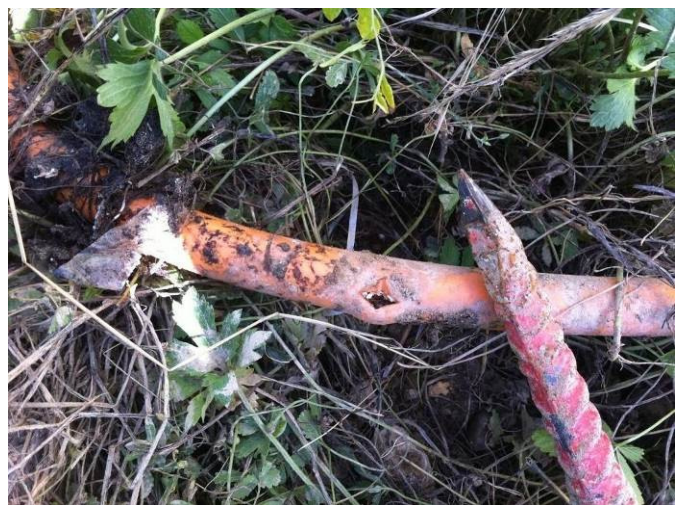
Beschädigtes PUR-Kabel ohne mechanischen Schutz
