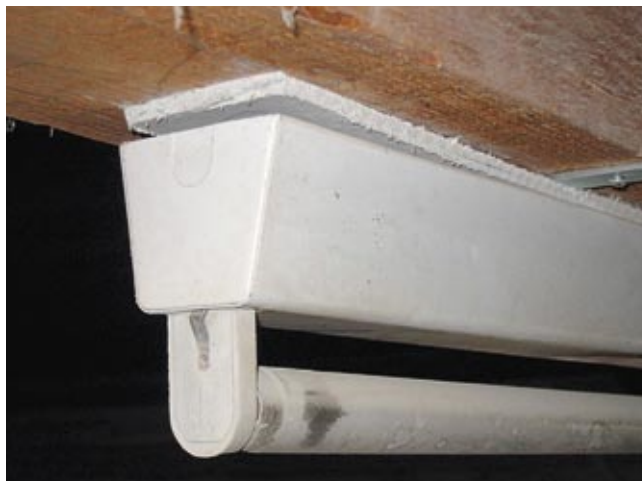
Asbesthaltige Leichtbauplatte unter FL-Armatur (schwach gebundener Asbest).
