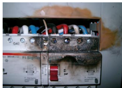
Figure 3 Court-circuit de 3,6 kA provoqué lors d'une mesure. L'équipement de protection individuel était disponible, mais pas porté, ce qui a provoqué de graves brûlures aux mains.
