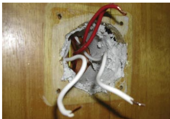
Isolation en amiante (amiante faiblement aggloméré).
