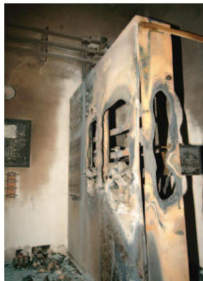
Figura 4 Apparecchiatura assiemata di protezione e di manovra danneggiata da cortocircuito.
