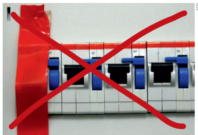
Figura 2 Per garantire la protezione contro il reinserimento, non basta bloccare gli interruttori protettivi di linea in posizione «disinserito» con del nastro adesivo.
