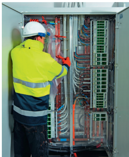
Immagine: lavorare sotto tensione.
