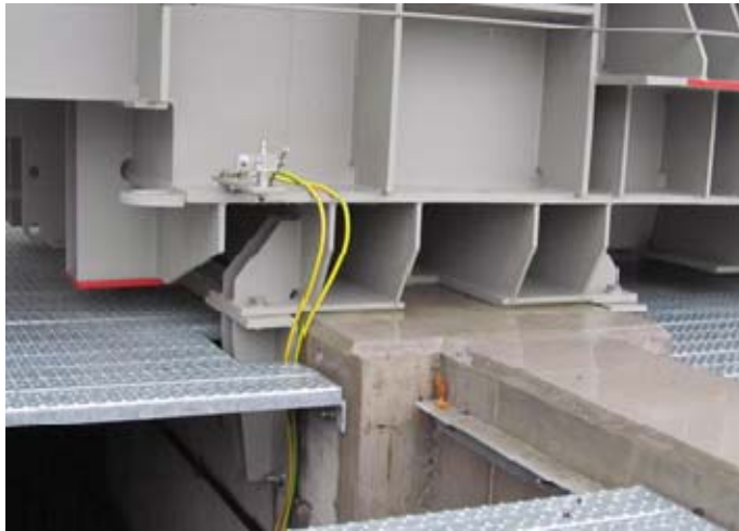
Figura B.1: Trasformatore 220 kV / 70 MVA – Zona sismica Z3b – Ancoraggi (8 rimovibili) direttamente sul basamento di fondazione (con l'autorizzazione di axpo).
