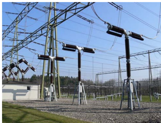
Figura 2: Interruttori di potenza da 380 kV collegati con gli apparecchi adiacenti mediante conduttori essenzialmente verticali: questa configurazione consente grandi spostamenti sismici senza che i conduttori si tendano.
