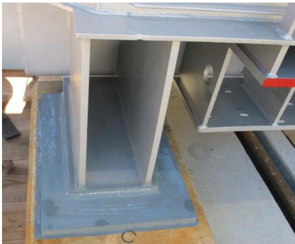
Figura B.2: Trasformatore 236 kV / 60 MVA – Zona sismica Z3b - Cornice di rinforzo saldata su placche di ancoraggio fissate nel cemento (con l'autorizzazione di ewz).
