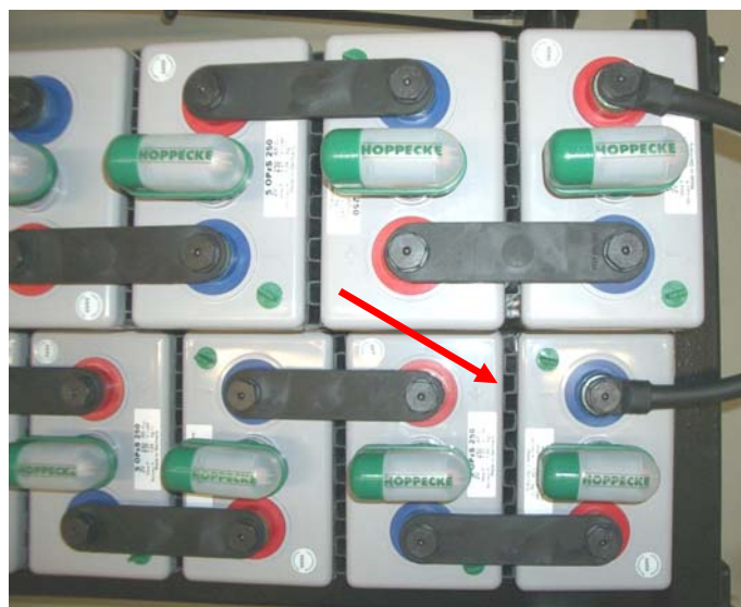
Figura E.2 Sottostazione Münchwilen (Axpö AG): inserti ondulati in materia plastica posizionati tra batterie adiacenti impediscono che esse battano l'una contro l'altra.
