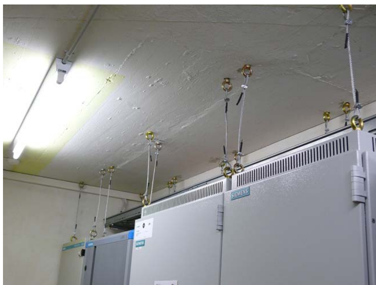
Figura E.5: Armadi di comando fissati alla parete attraverso cavi (organizzazione di crisi Cantone di Basilea Città)
