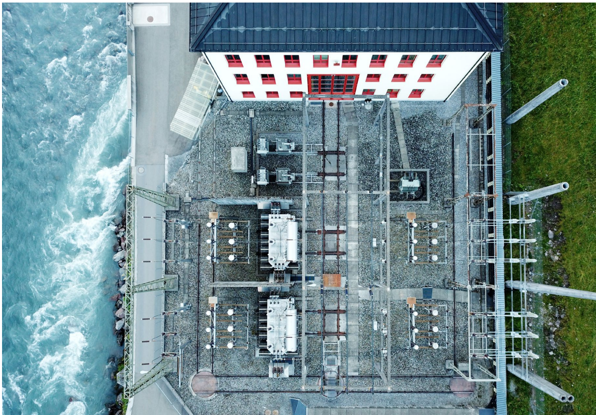
Abbildung 3 Die heutige Freiluftanlage des Unterwerks Schwanden GL (Bild: SN Energie)
