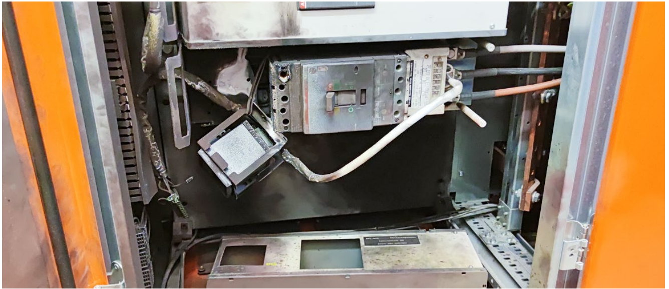
Abbildung 5 Kurzschluss an einem Energiezähler vor dem Leistungsschalter
