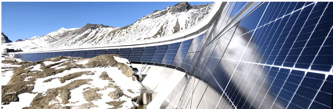
Abbildung 4 Photovoltaikanlage Muttsee 2400 kWp auf 2474 m.ü.M
