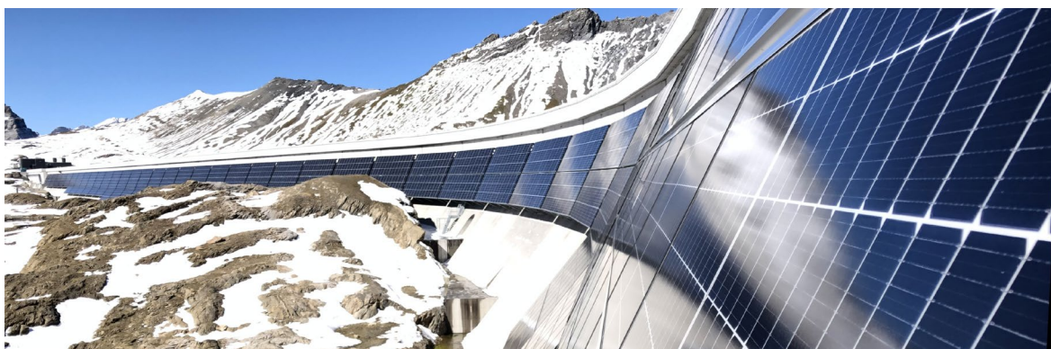
Figura 4 Impianto fotovoltaico di Muttsee da 2400 kWp a 2474 m s.l.m
