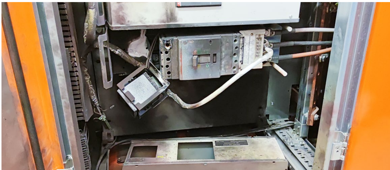
Figura 5 Cortocircuito a un contatore di energia a monte dell'interruttore di potenza
