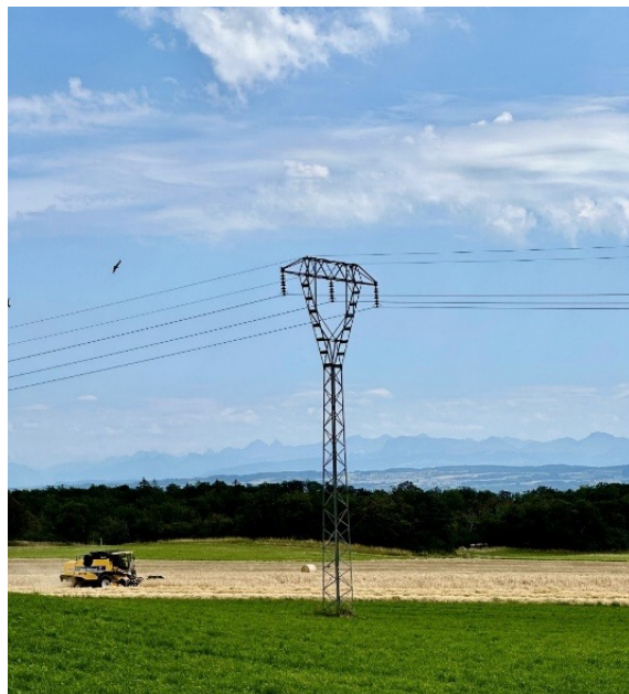
Abbildung 4 Freileitung bei Romainmôtier (VD) mit Kappenisolatoren
