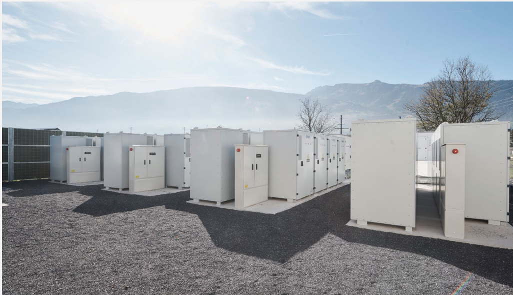
Abbildung 3 Leistungsstarker Batteriespeicher beim Umspannwerk Sargans (SG)
